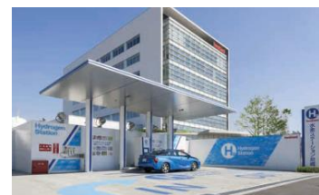
水素ステーション
